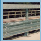
Glissières de sécurité et garde-corps
