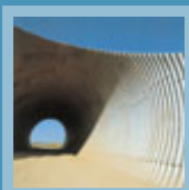
Condotte in acciaio ondulato e zincato
